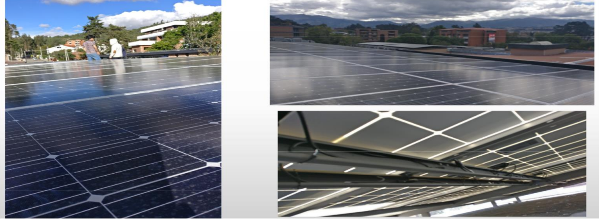
Figura 2. Paneles solares Laboratorios de la Escuela de Ingeniería Civil.
