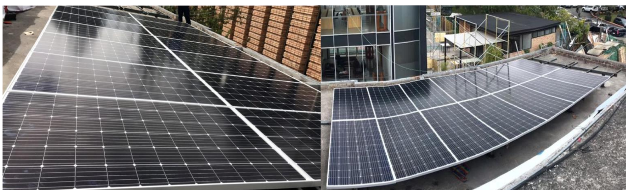
Figura 1. Paneles solares Biblioteca Hernán Malo.
