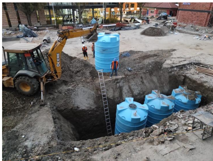
Anexo 1: Fotografía tanques enterrados
